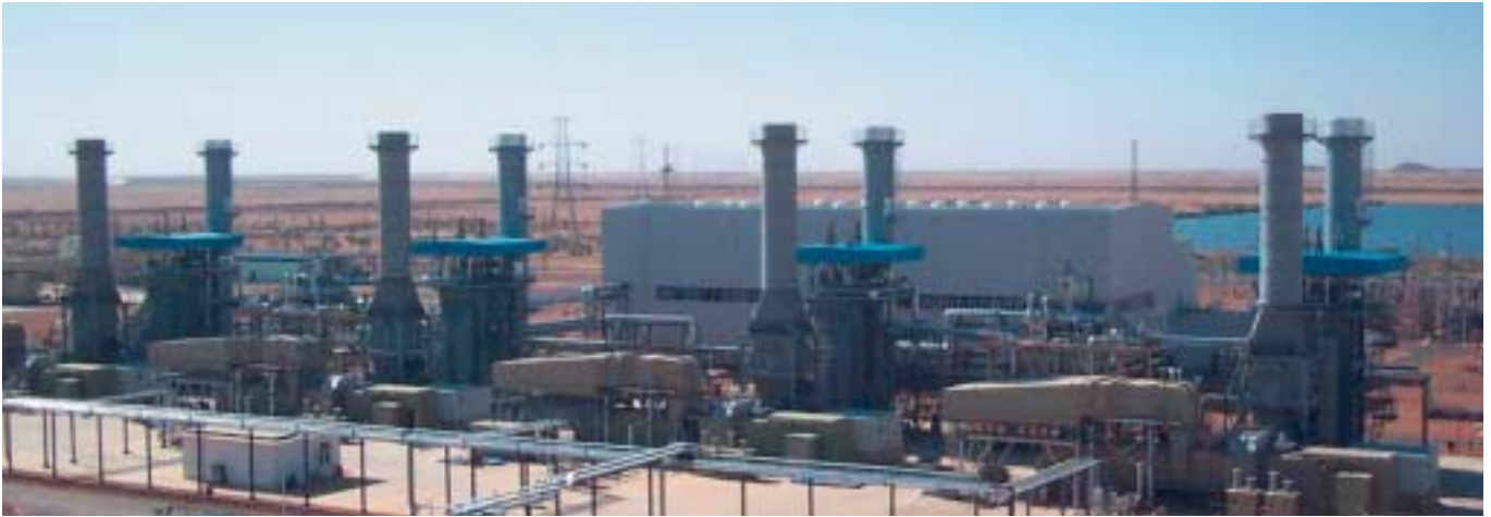
Das bestehende 190-MW-Kombikraftwerk Garri 1.
