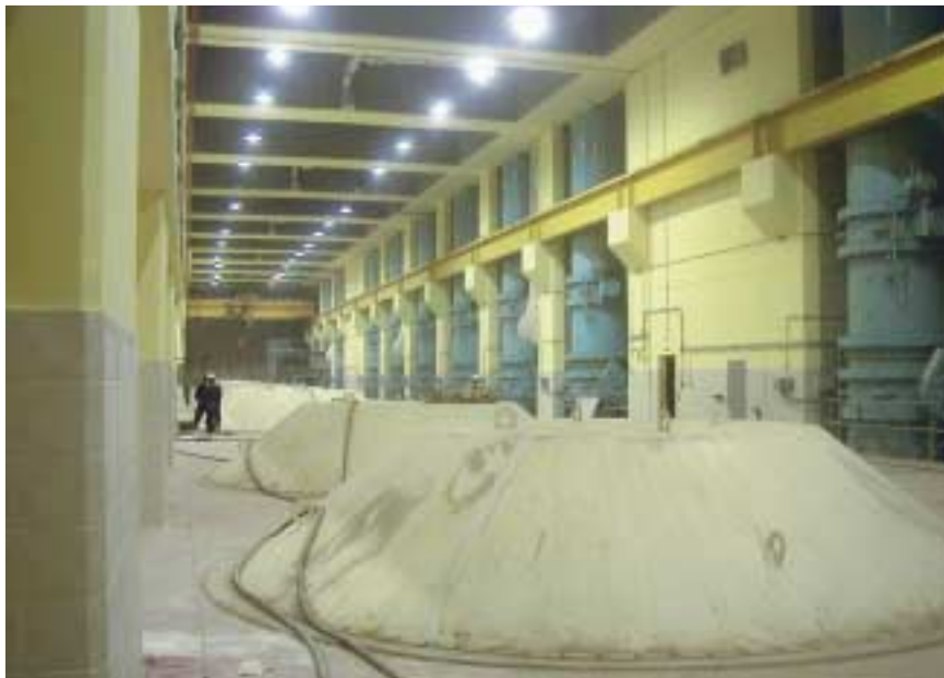
Blick in die 140 m lange, 14 m hohe und 17 m breite Pumpenhalle Nord.
